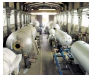
Contenedores de gas CO2 líquido
